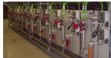
zentrale Probenahmestation in einem HKW
